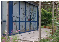
Mögliche Gefahrenbeseitigung durch Aufziehen einer Milchglasfolie aussen an der Scheibe.
